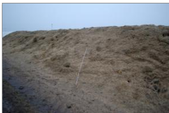
Halmledet vid brytning av stukan den 9 januari 2014. Ojämnt och med hål i.
